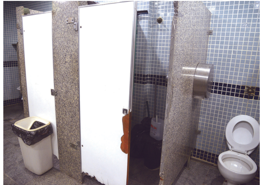
O banheiro da agência do BB na Cidade de Deus, em Jacarepaguá, está em condições precárias de uso, prejudicando funcionários e clientes
