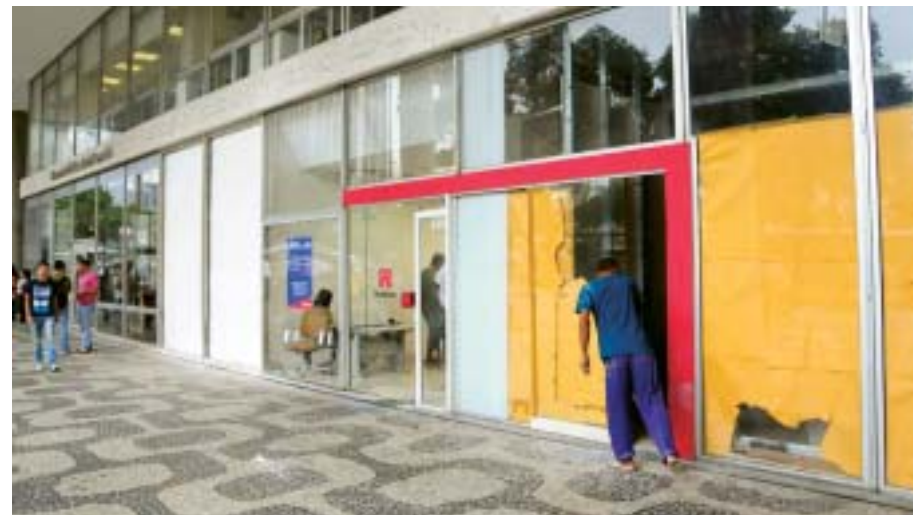
Agência do Bradesco na Presidente Vargas, em obras e sem vigilantes, aberta ao público. Clientes e usuários correm risco ao utilizarem terminais sem o mínimo de segurança
